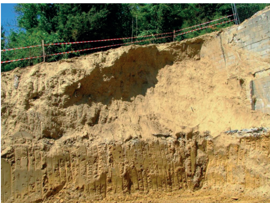
Építőipari célvizsgálat során készült fénykép omlásveszélyes földfalról
